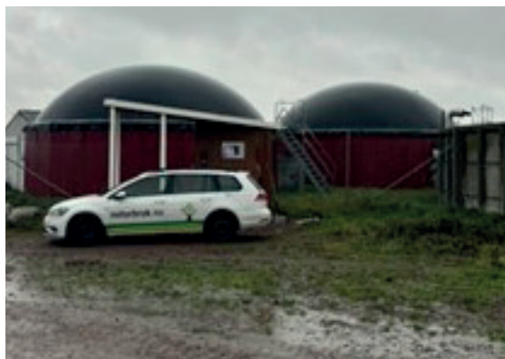
Lokal tankstation på Sötåsensskolan framför den renoverade biogasanläggningen.
